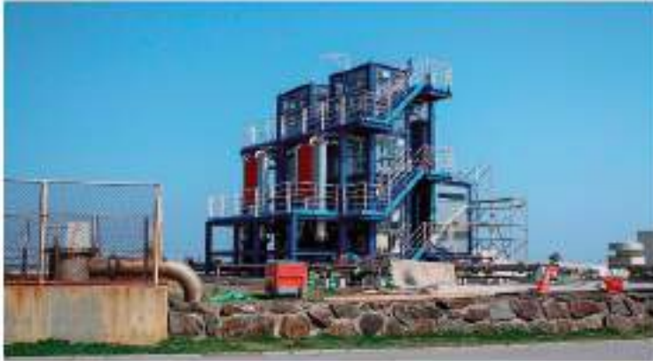
Figura 23. Planta OTEC on-shore, de ciclo cerrado en la Isla Kumejima, Japón. Fuente: KumeGuide.com. Recuperada de https://goo.gl/Nvfzpv .
