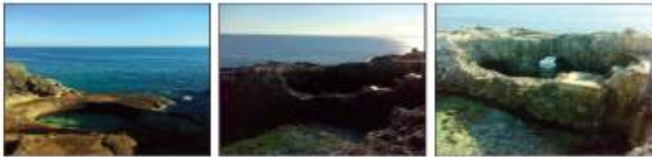
Figura 21. Restos de la antigua planta OTEC de Bahía Matanzas, Cuba. Fuente: García-Huante (2015). Posibles efectos oceanográficos por la operación de una planta OTEC en la zona de Puerto Ángel, Oax. México. (Tesis de Maestría). Universidad Nacional Autónoma de México. México D.F.
